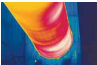
Détérioration du matériau réfractaire d'un four à ciment rotatif
